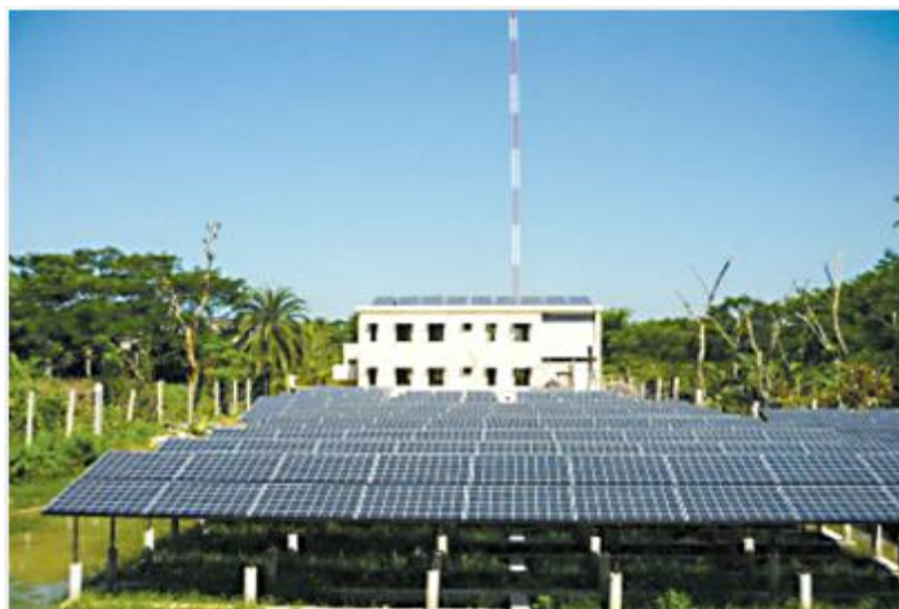
Figure 3.10: Solar Mini Grid
