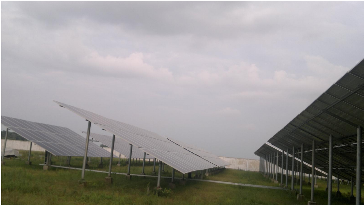
Figure 3.11: Solar Mini Grid
