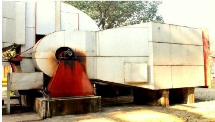
Figure 2.10: FD fan for 150 MW & 15.75 KV unit 4.
